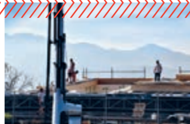
Im Oktober wurde das Dach im Westtrakt angehoben und nach wenigen Tagen geschlossen. Fußnegger Holzbau und die Spenglerei Ganath ergänzten sich dabei bestens.
